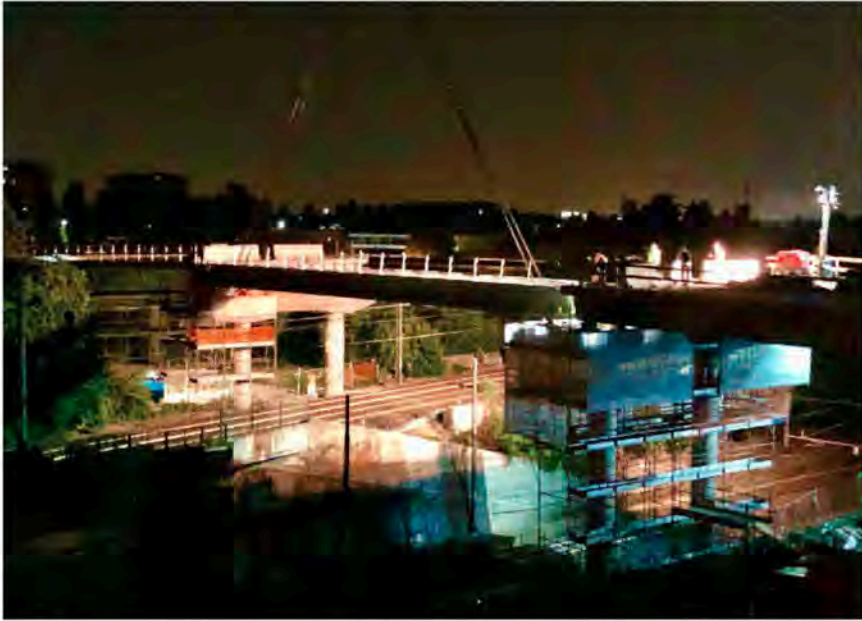
Lavori per il posizionamento delle travi svolti in sole due notti del 22 e 23 luglio
